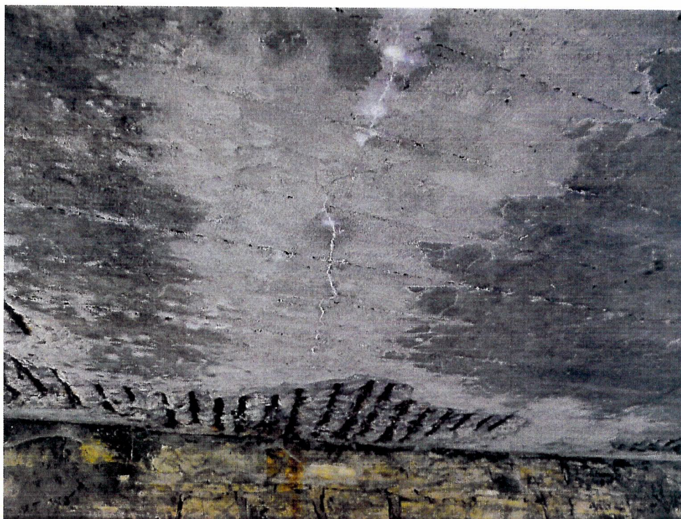
Fot. 9. Widoczne rdzawe nacieki na przyczółku oraz wyługowania na rysach podłużnych
