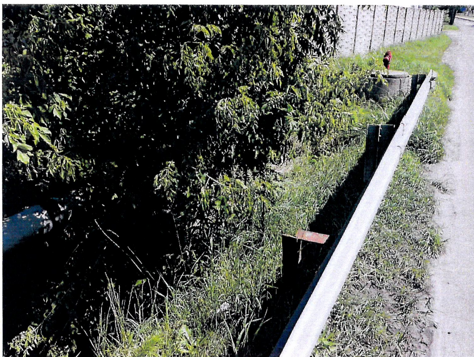
Fot. 12. Widoczne zanieczyszczenie jezdni, wegetacja roślin na naziomiu, korozja bariery
