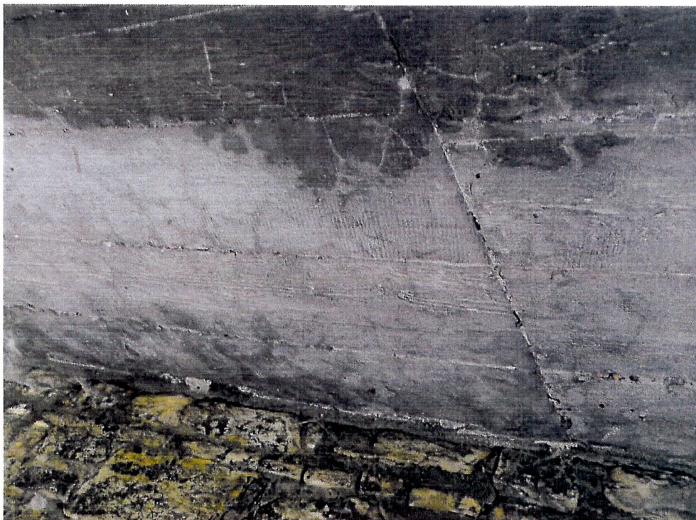
Fot. 10. Widoczne zawilgocenie przęśła i przyczółka na przyczółku oraz wyługowania na rysach
