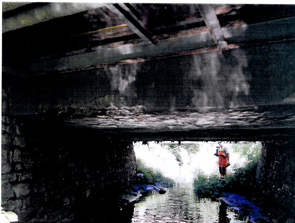
Fot. 14. Widoczny stan przestrzeni podmostowej – brak umocnień przyczółków, nieumocnione dno cieku
