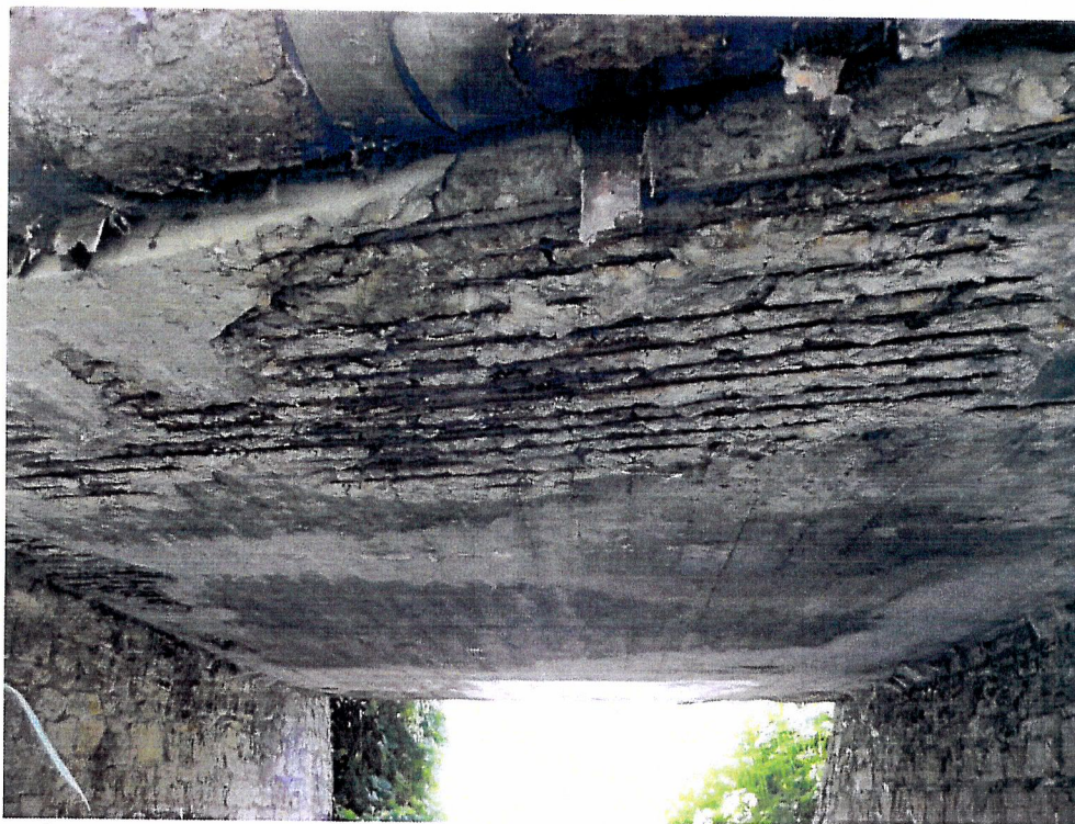
Fot. 7. Spód płyty pomostu – widok ogólny, zawilgocenie, obszerne ubytki betonu oraz zaawansowana korozja zbrojenia
