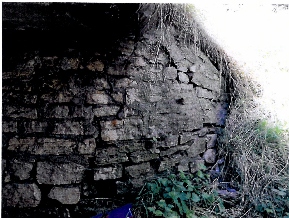
Fot. 6. Przyczółek 2, widoczne zacieki wody, ubytki fug, spękanie na połączeniu skrzydło – korpus
