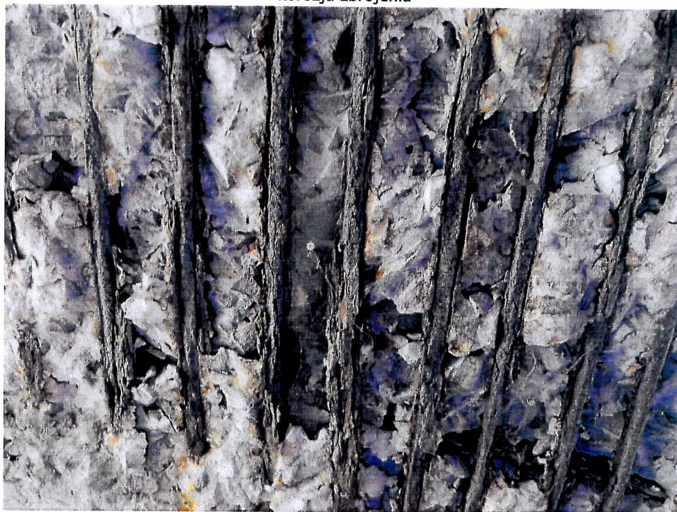
Fot. 8. Zbliżenie na układ prętów głównych – widoczna zaawansowana korozja zbrojenia
