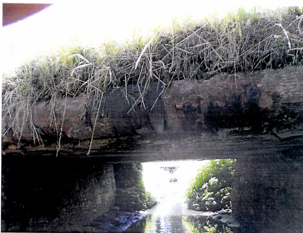
Fot. 13. Widoczny naziom oparty na urządzeniu obcym, korozja rury osłonowej urządzenia obcego
