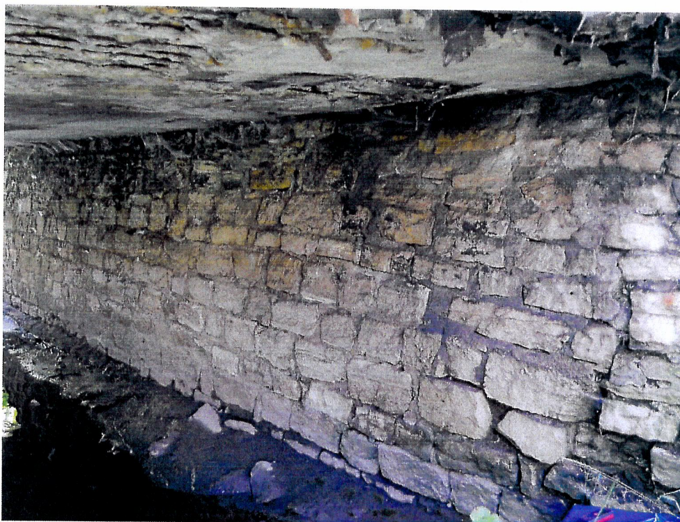
Fot. 5. Przyczółek 2 – widok ogólny, widoczne miejscowe zacieki wody, wypłukanie fug, korozja kamienia
