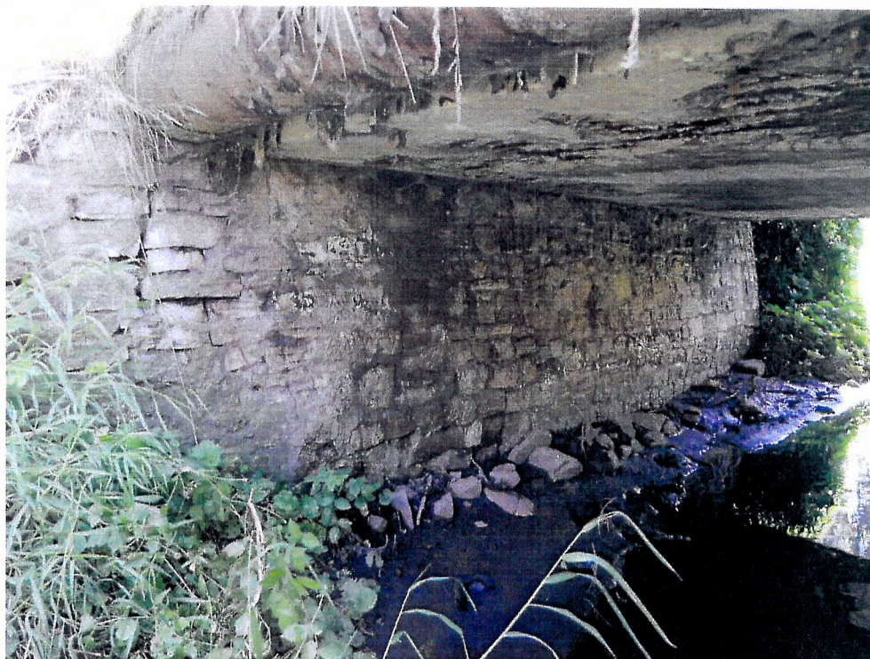
Fot. 3. Przyczółek 1 – widok ogólny, widoczne miejscowe zacieki wody, wypłukanie fug, korozja kamienia
