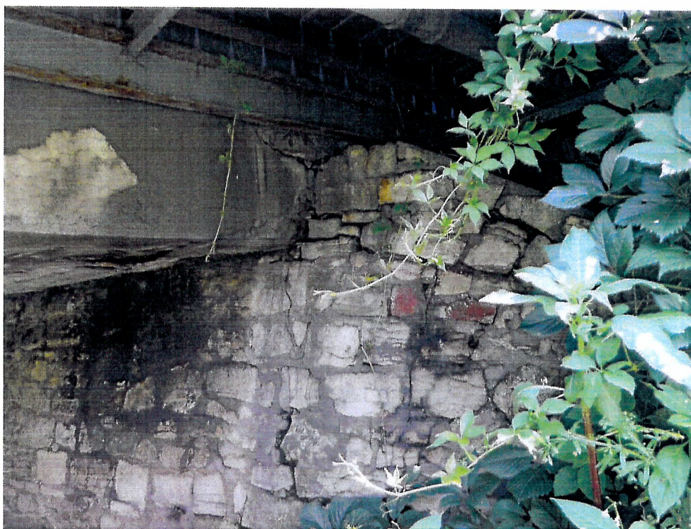
Fot. 11. Widoczne pęknięcie na linii korpus – skrzydło oraz spękanie ukośne w miejscu podparcia
